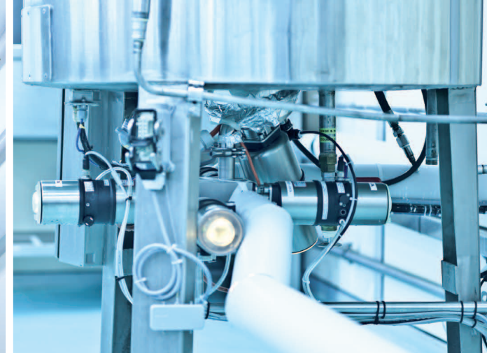
Ensemble de vannes en fond de cuve de préparation avec capteur de niveau intégré.
