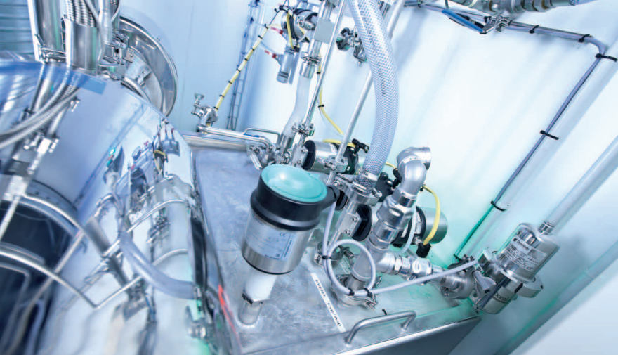
Poste de dosage de désinfectant pour le NEP.
